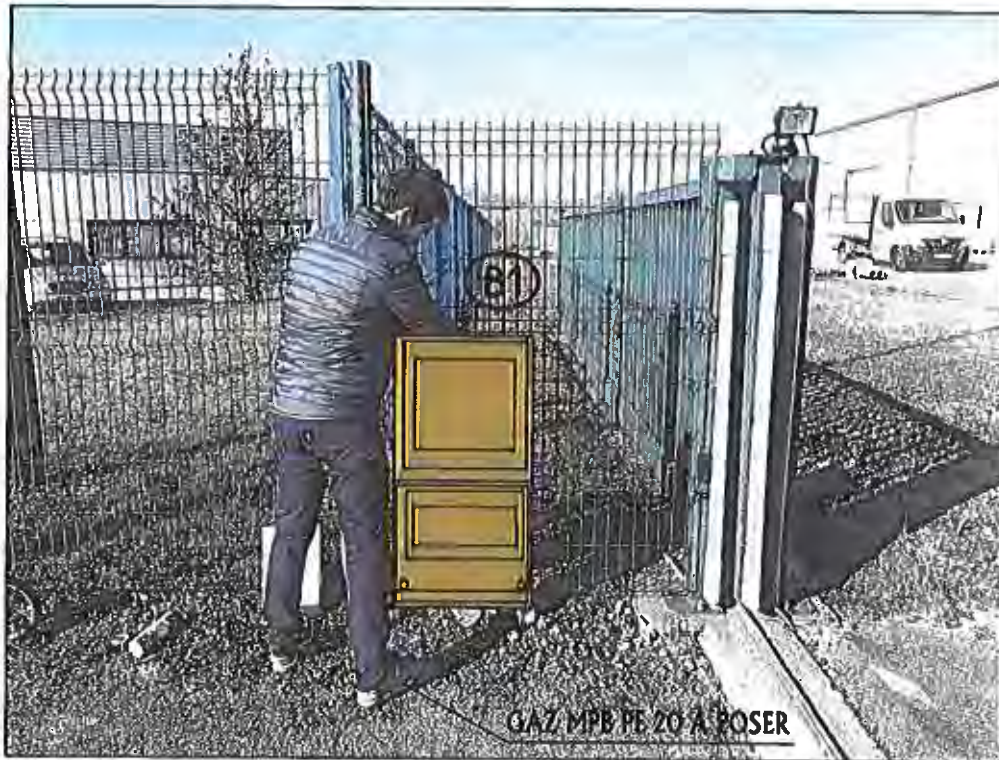
Photo d'implantation du coffret Gaz B1
